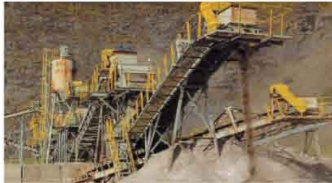
【混合プラント】
